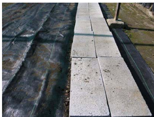
Figura 17. Bancada para colocación de bolsas.
